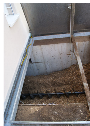
Befüllgasse mit Förderschnecke
