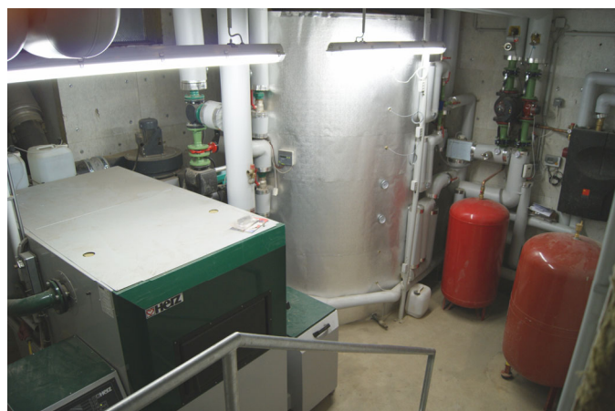
Kesselanlage mit Pufferspeicher
